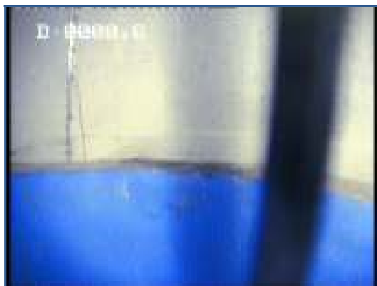
Sommet des tubes en PVC situé dans la réhausse de la tête de puits
